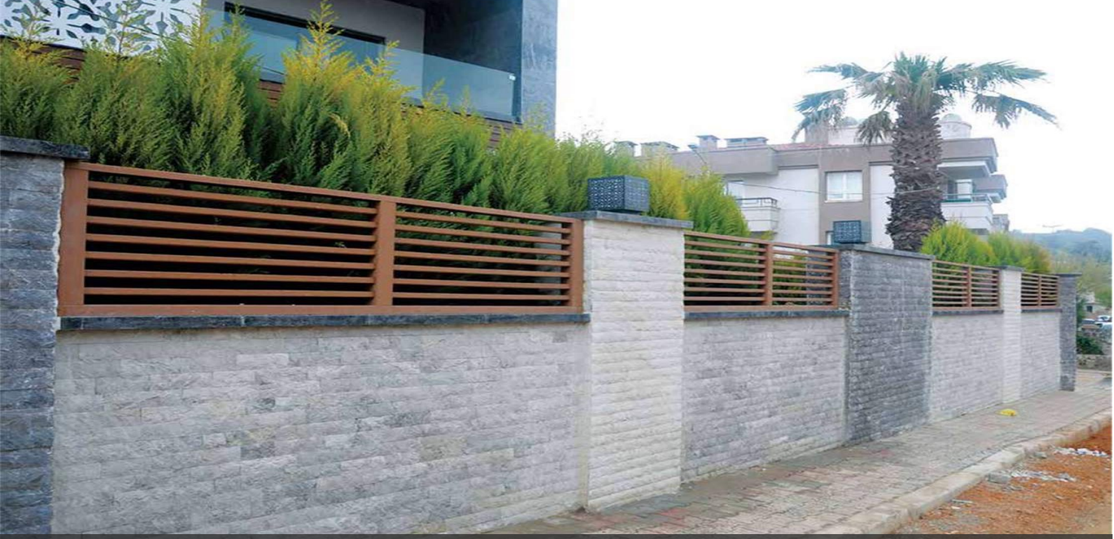
Ahşap kompozit dekoratif çit uygulaması
